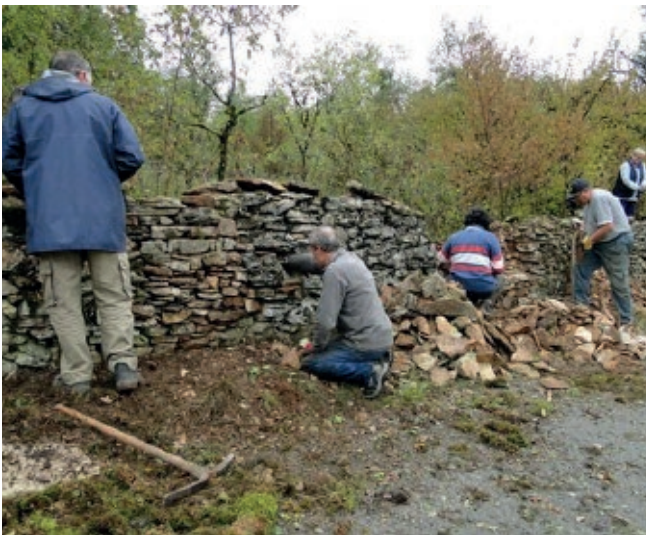
Remise en état des murets lors de l'événement « 1 000 mains à la pâte pour le GR 65 »
